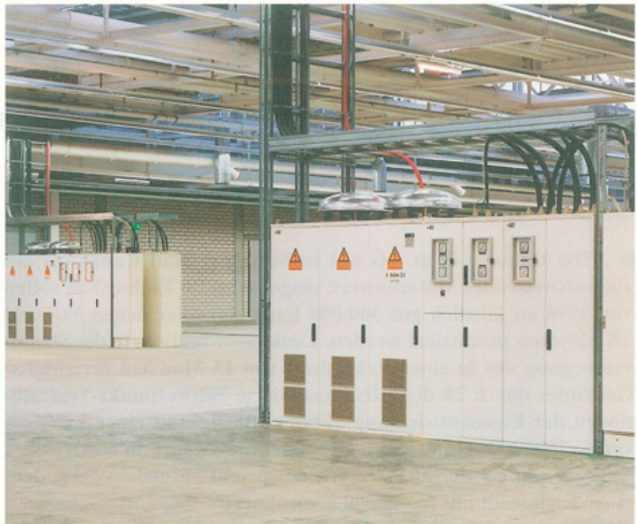
▲ Umspannung direkt in den Lastschwerpunkten (Stationen Typ EnergieBlock)
